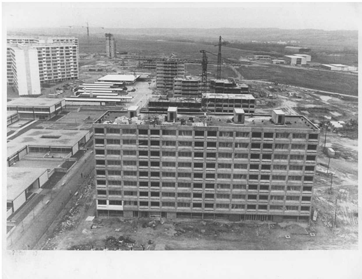
Chantier de la construction - Mise en place des grues sur rail et achèvement de l'élévation des barres de Beauval. Vue de l'école primaire et du collège Camus- après le 10 octobre 1969. (OPAC Meaux)
