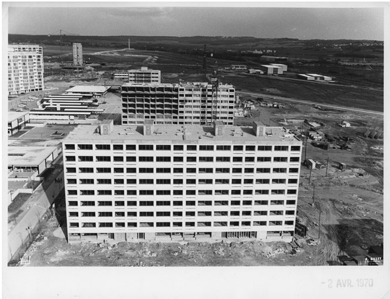
Chantier de la construction - Mise en place des grues sur rail et achèvement de l'élévation des barres de Beauval. Vue de l'école primaire et du collège Camus - 2 avril 1970. (OPAC Meaux)
