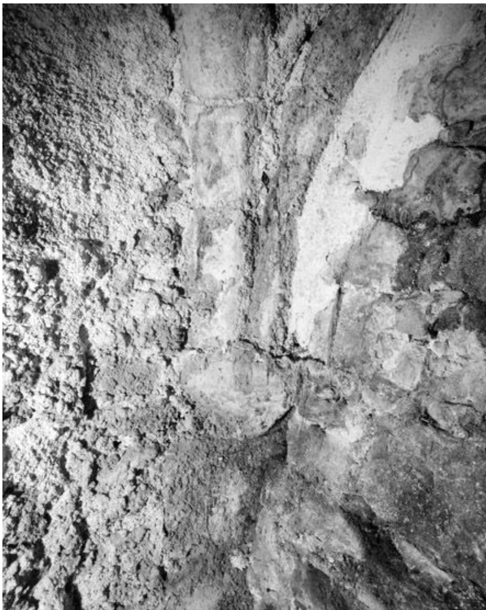
La cave médiévale : détail du corbeau au milieu du mur est (côté rue Eugène-Briais), aujourd'hui flanqué par un mur de refend postérieur (partie droite de la photo).
