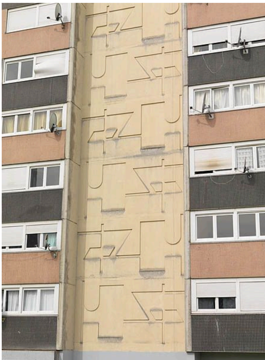
Une tour de la Pierre-Collinet. Détail de la mise en oeuvre du béton moulé sur la façade arrière.
