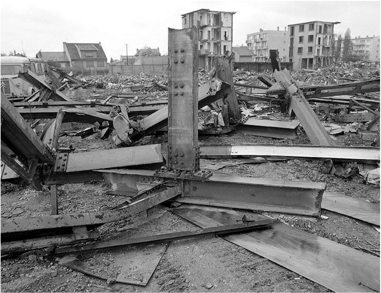
Détail des ossatures métalliques d'une tour. Campagne photographique, lors de la destruction du bâtiment en 1976.
