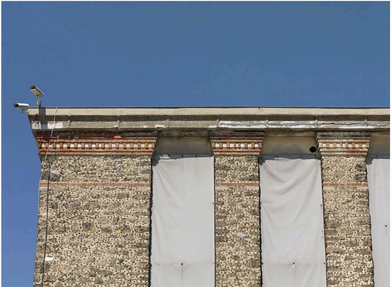
93, Courneuve (La), usine de construction mécanique Mecano, 33 avenue Victor-Hugo. Détail de la façade de l'atelier principal.
