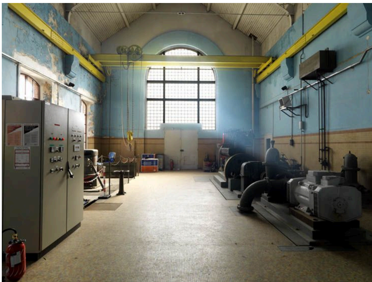
Bâtiment des pompes, salle des machines.
