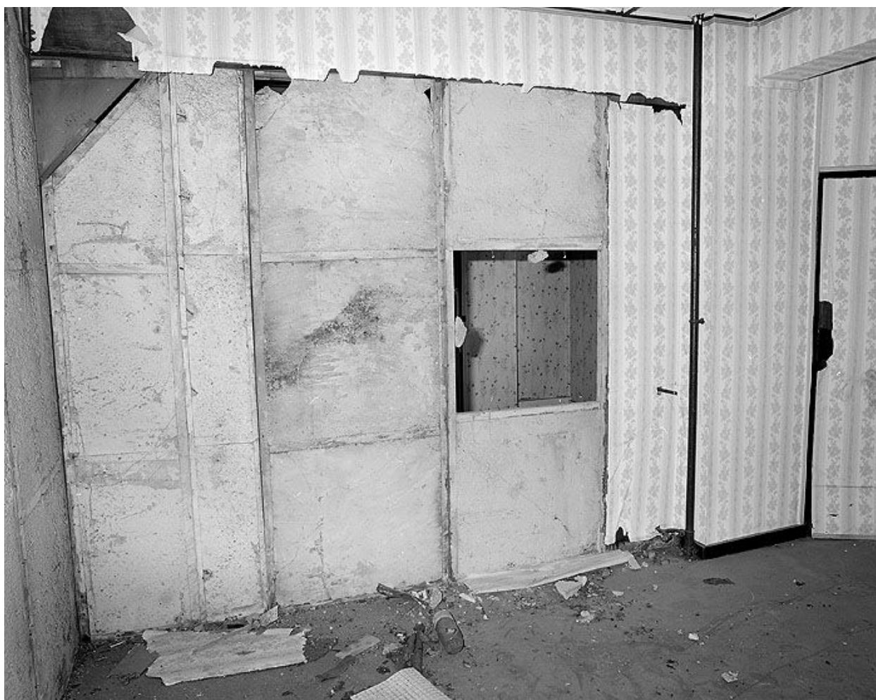
Tour 5 - 3ème étage, façade ouest. Construction d'un mur intérieur. Campagne photographique, lors de la destruction du bâtiment en 1976.
