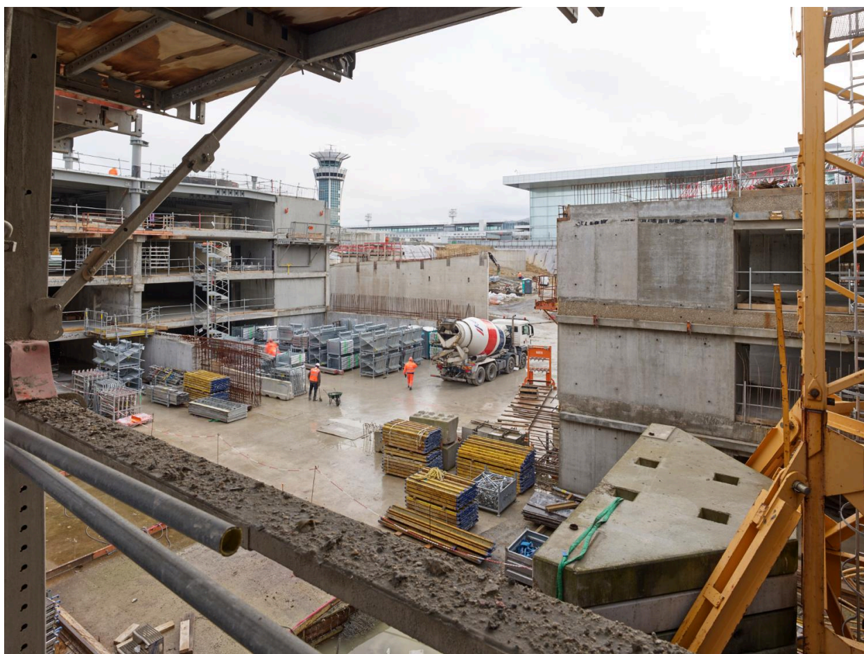
16/12/2020, chantier de construction de la station de métro Aéroport d'Orly (lignes 14 et 18) vu depuis le nord ouest.
