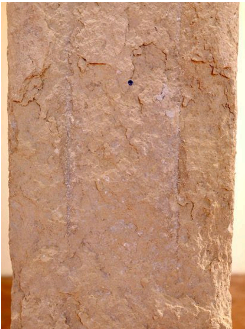
La salle basse occidentale : détail d'un pilier, montrant l'érosion de la pierre.
