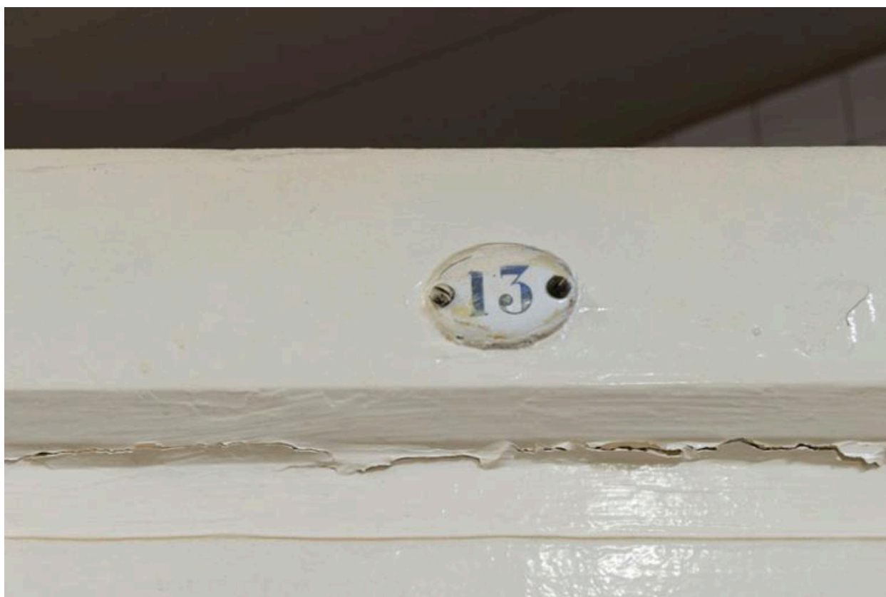
Détail d'une plaque ronde en faïence, portant le numéro d'une cabine.
