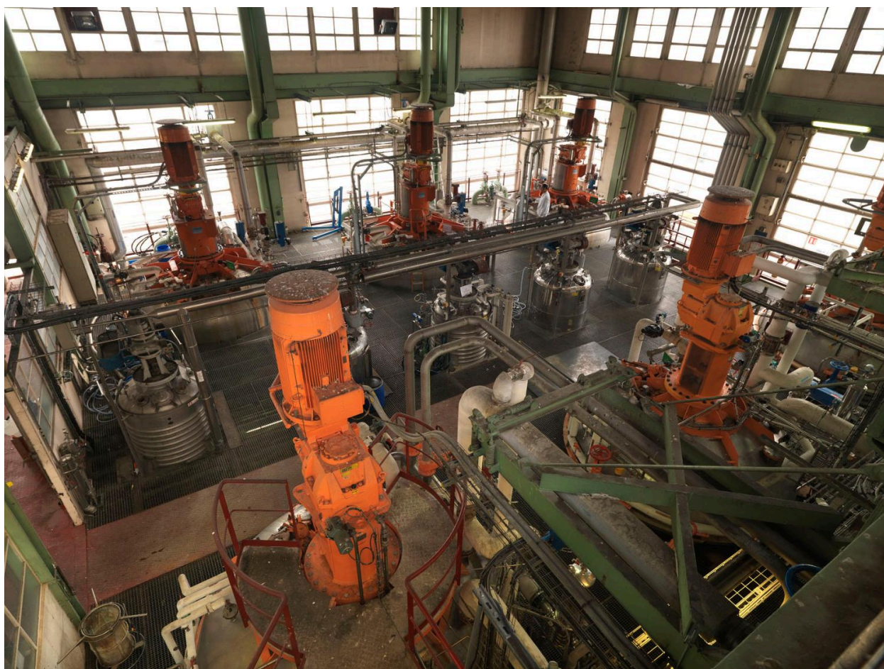
Site Sanofi. Bâtiment de transformation. Cuves.
