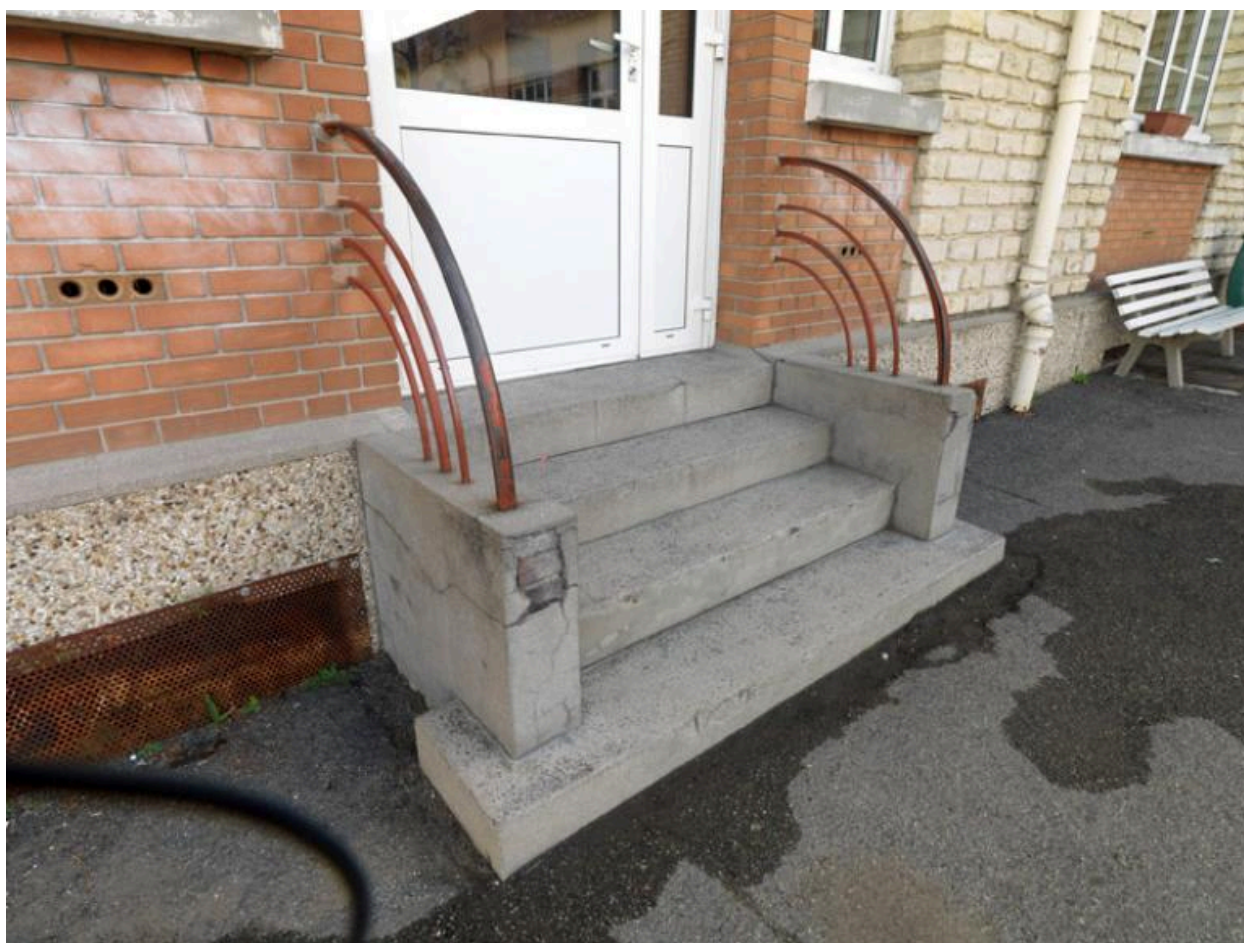
Détail soigné des marches desservant le bâtiment donnant sur la rue Pierre-Curie.
