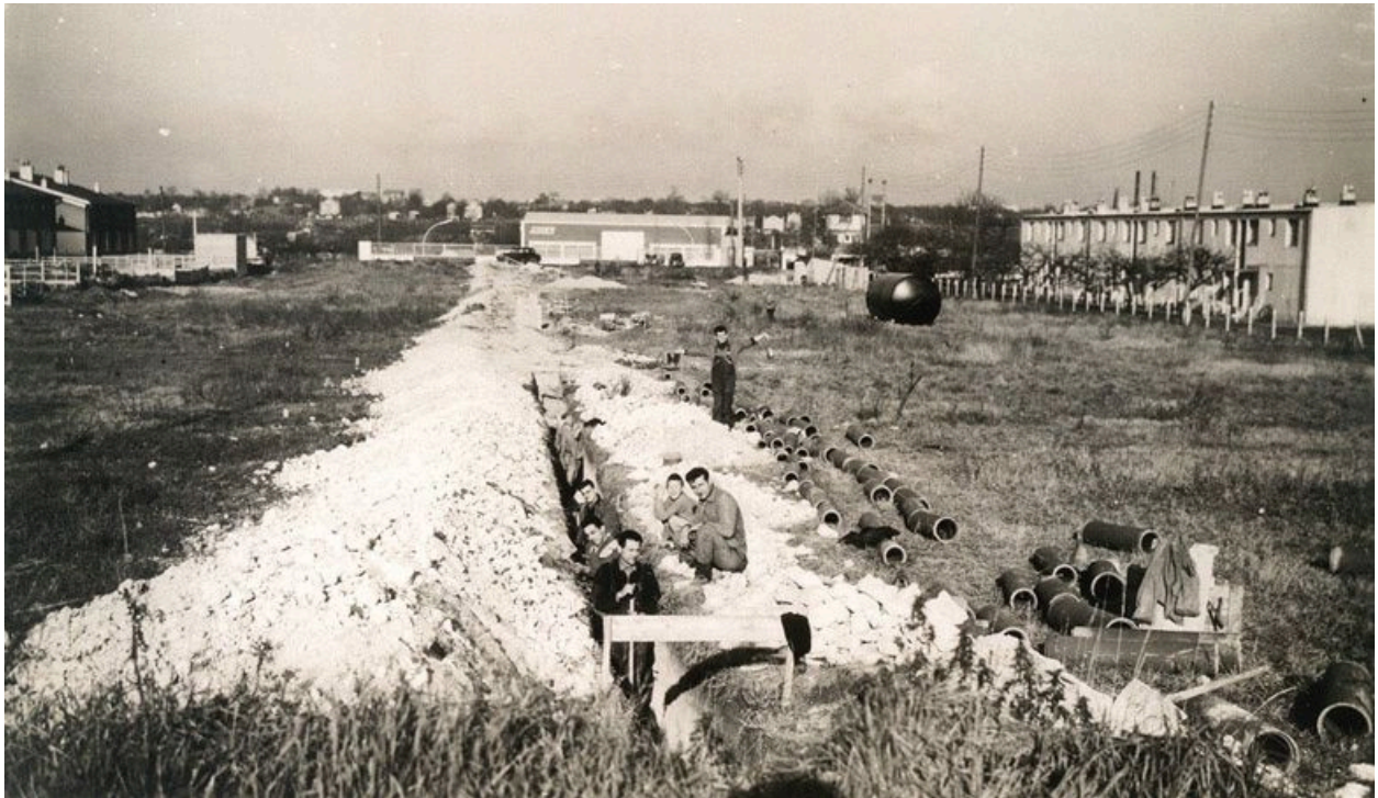
Vue du chantier du lotissement concerté dit Castors de La Pipée, rue de la Pipée. Les Castors creusent la tranchée pour les canalisations d'assainissement. Photographie, 1959. (Collection particulière)
