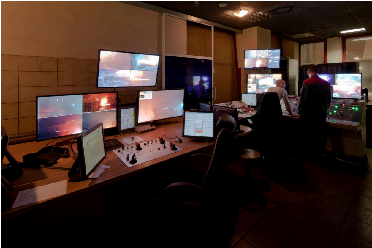
Halle du four, poste de commande du four électrique. (réf. Département Seine-et-Marne : IVD77_2013_77_00241_NUCA)
