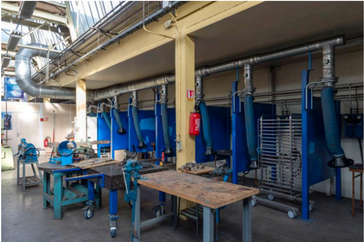
Lycée Rostand : l'atelier de la section Réalisations industrielles en Chaudronnerie et Soudures (RICS). Système d'aspiration pour les scories.
