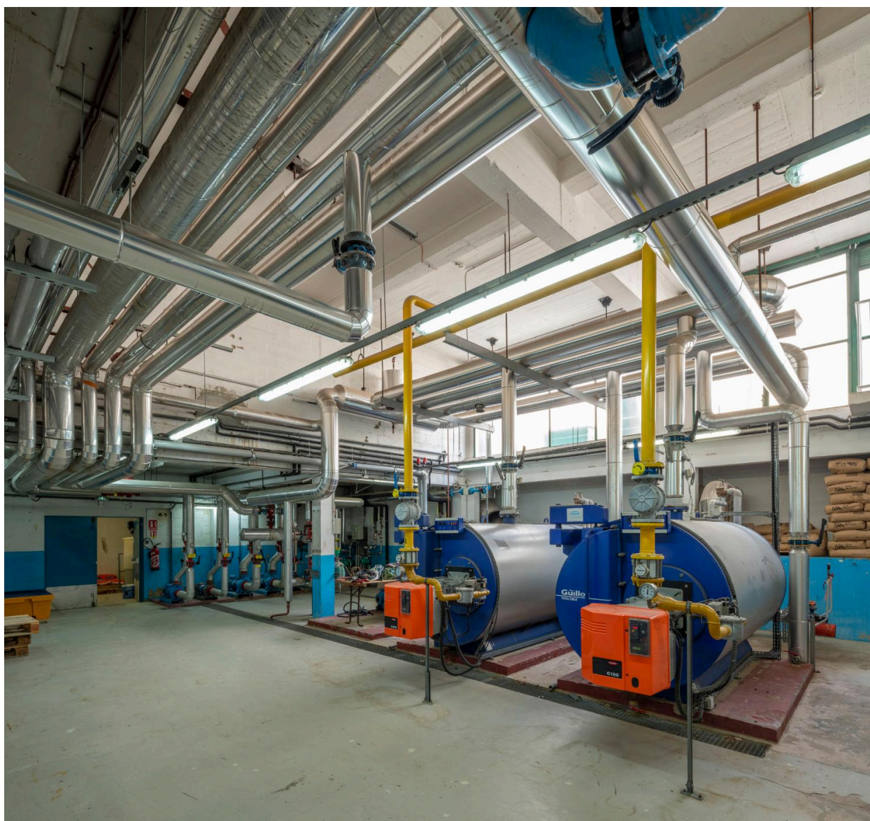
Vue intérieure du local de traitement d'eau, premier sous-sol
