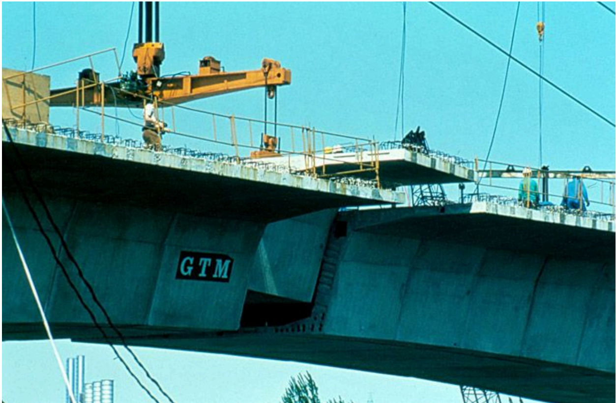
Choisy-le-Roi, Alfortville, Vitry-sur-Seine. Pont de Choisy de l'A86. Vue du chantier. Mise en place du dernier voussoir fermant une arche. Photographie. (Ecole nationale des ponts et chaussées. 2 S 039)
