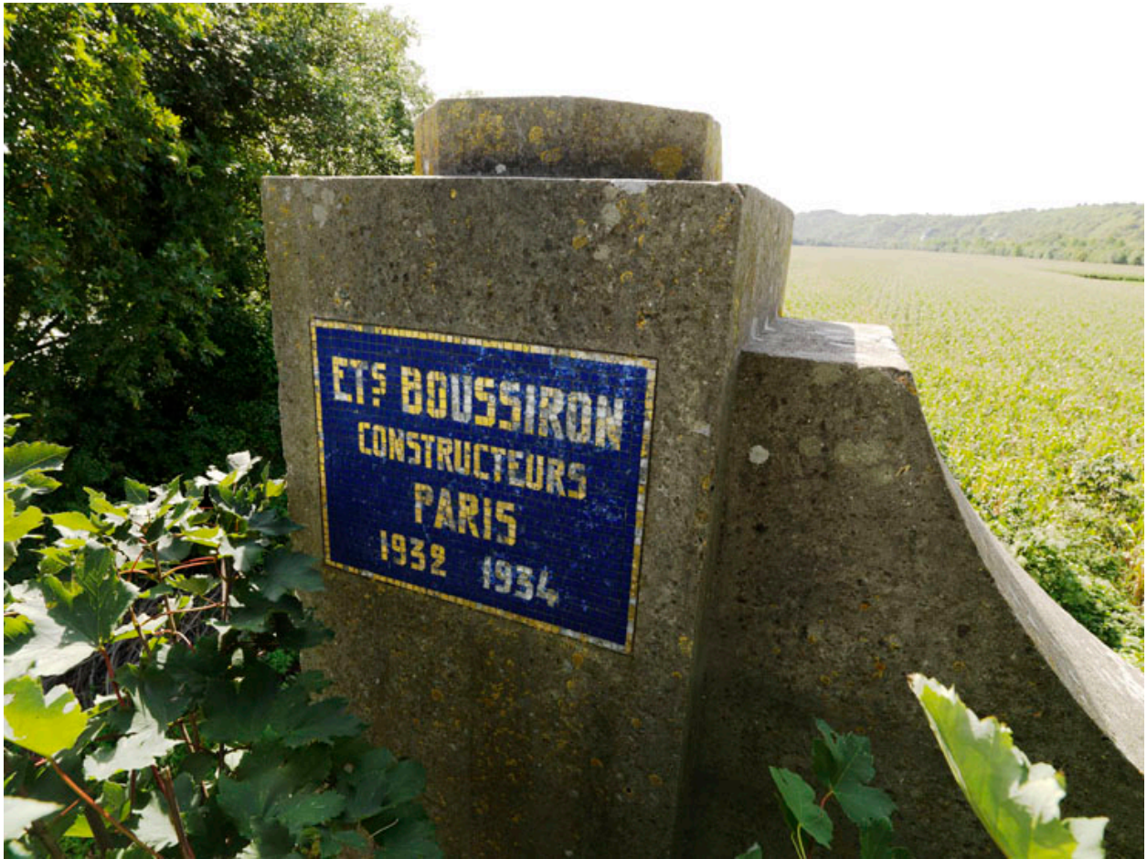
Plaque sur la pile du pont indiquant le nom du constructeur et la date des travaux.
