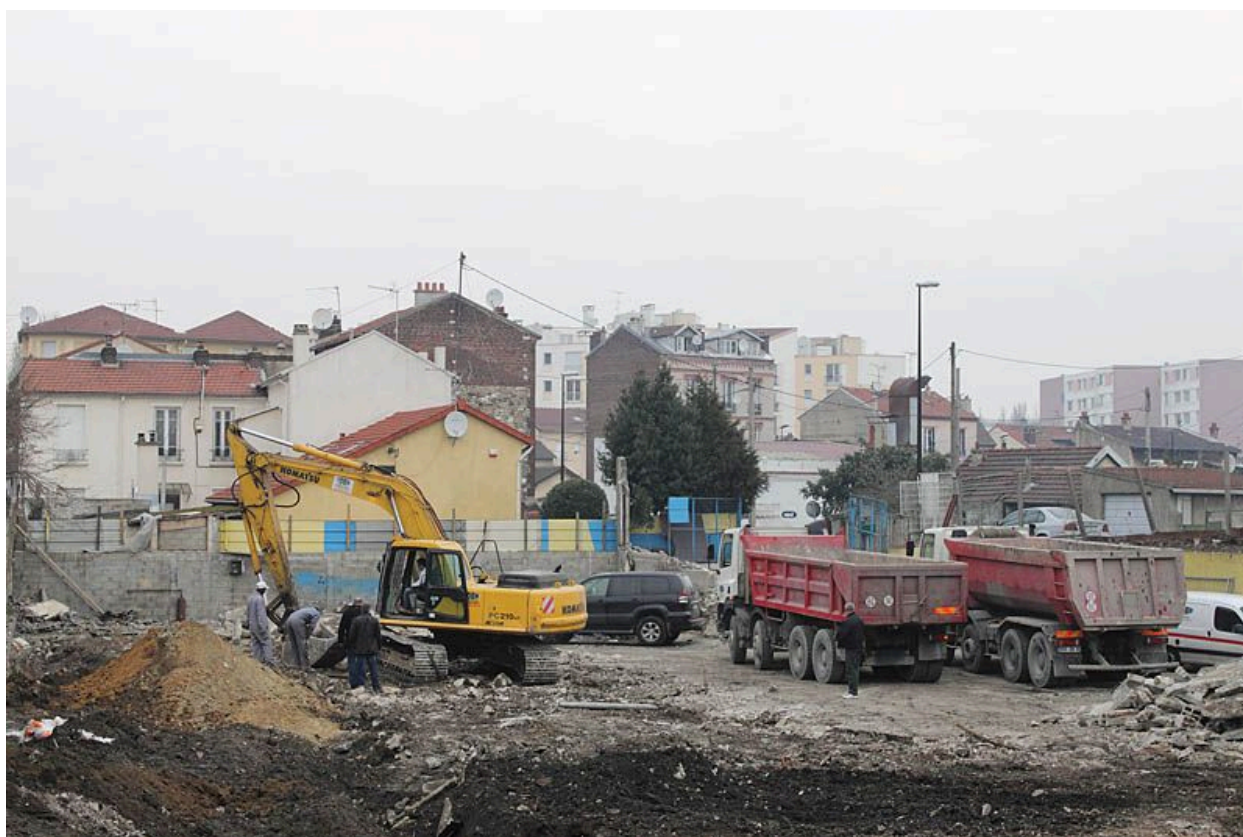
93, Saint-Denis, quai du Canal. Vue générale vers le nord-ouest depuis le pont du cours du Ru de Montfort.
