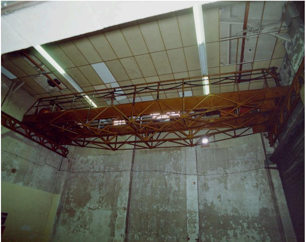
Pont roulant de l'atelier de soudure et de montage, dernier élément technique de l'usine.
