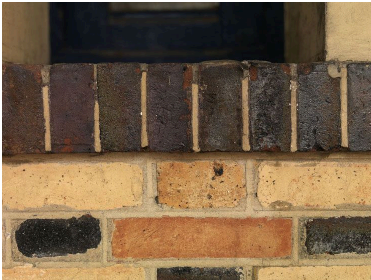
92, Sceaux, lycée Lakanal, 3-7 avenue du Président-Franklin-Roosevelt. Grande galerie nord-sud : briques polychromes et chaperon de briques émaillées aux joints surlignés.
