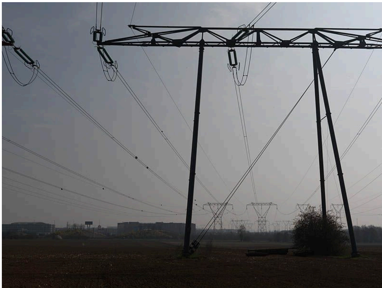
95, Roissy-en-France. Vue générale des champs et les lignes électriques.
