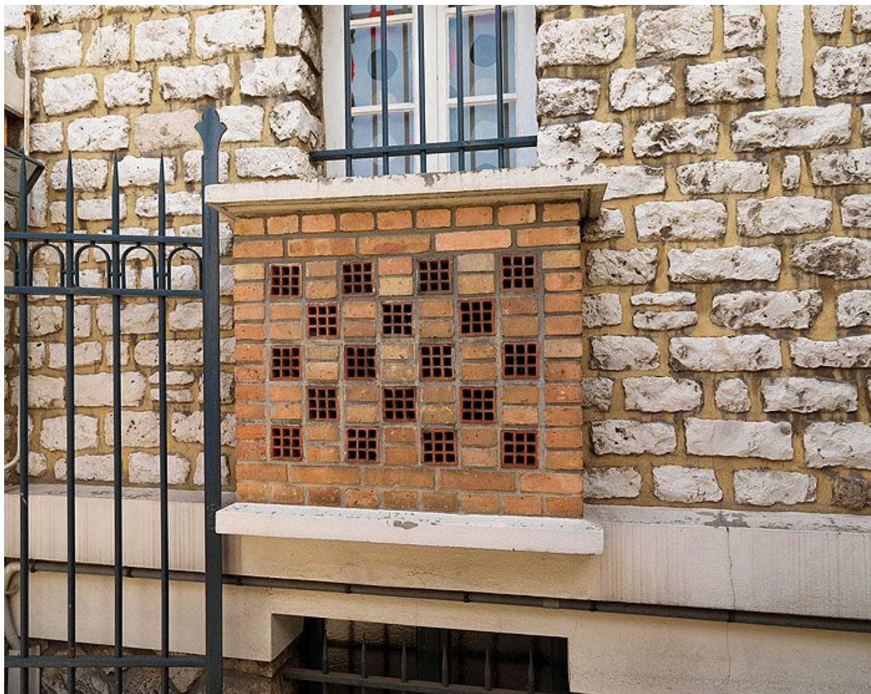
94, Choisy-le-Roi, maison, 10 rue Ledru-Rollin. Détail du garde-manger traité en claustra de brique, disposé sur la façade latérale de la maison.
