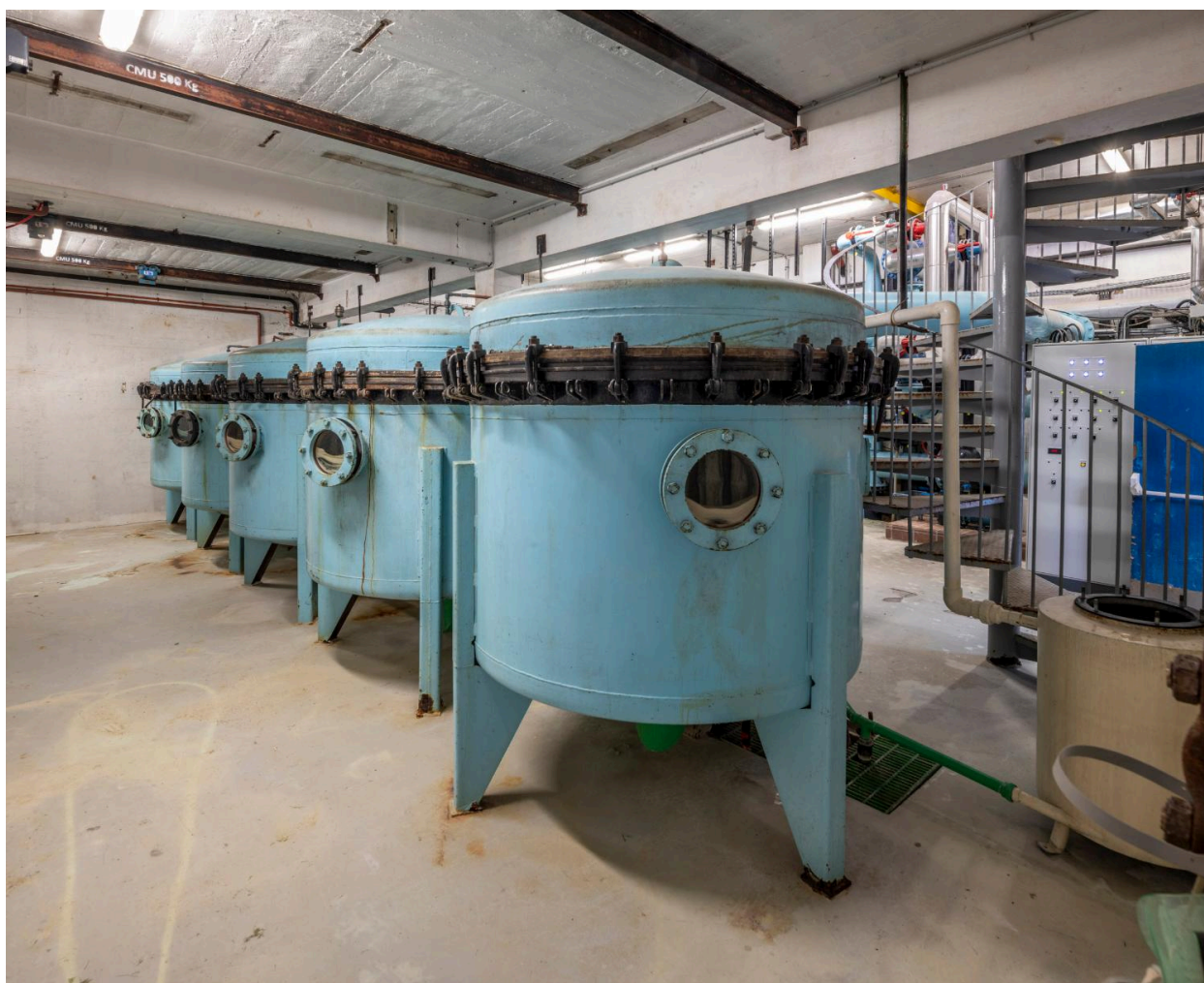
Vue intérieure du local de traitement d'eau, premier sous-sol
