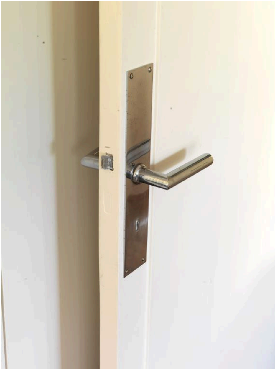
Détail d'une poignée de porte de la mezzanine de l'atelier de Mallet-Stevens
