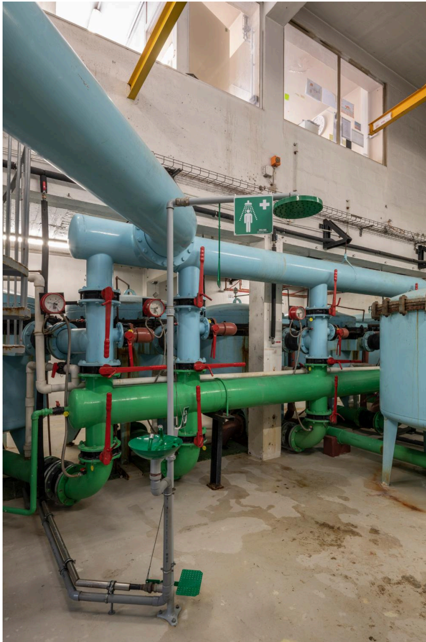
Vue intérieure du local de traitement d'eau, premier sous-sol
