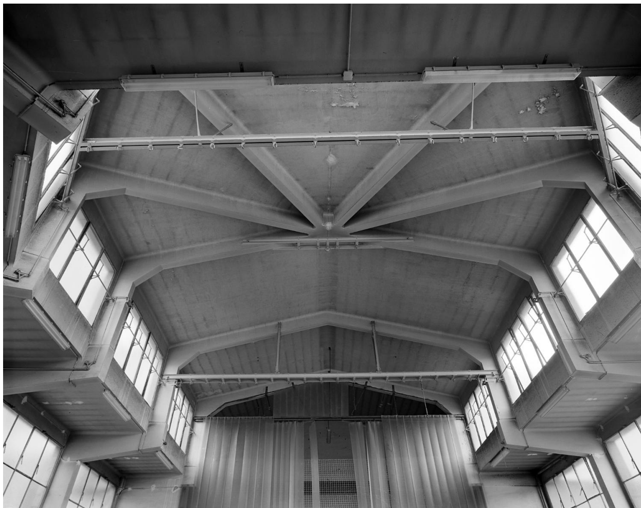
Gymnase Nouveau. Détail de la structure porteuse, vue vers la tribune. Etablissement Administratif Communal
