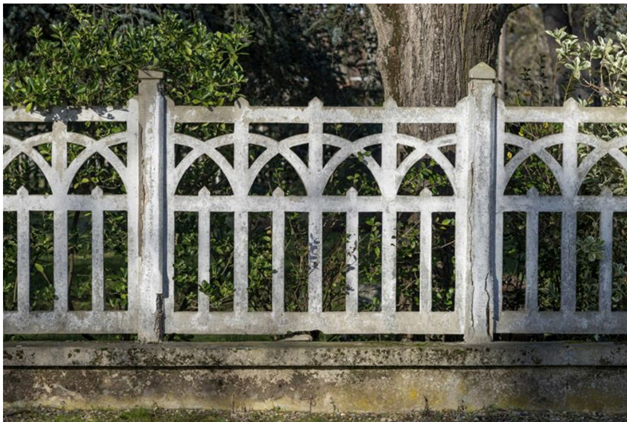
Maison, 6, boulevard Jacques Bertin. Détail de la barrière en ciment d'un modèle courant fabriqué par l'Entreprise Grondel.
