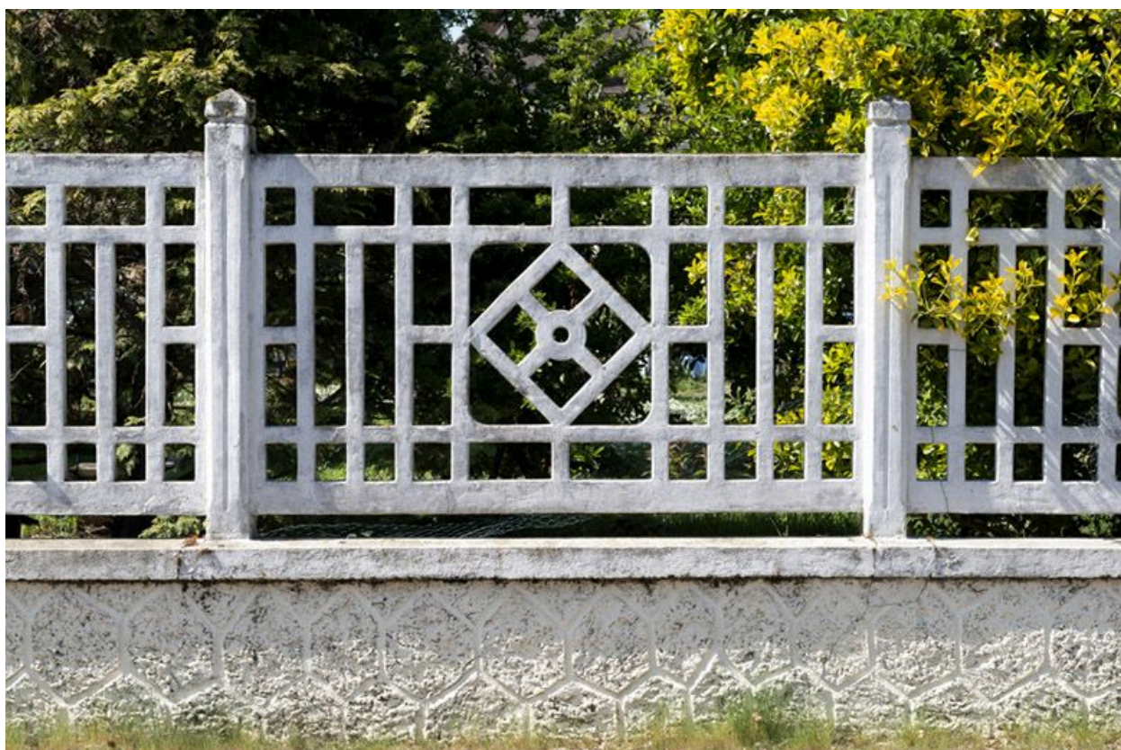
Modèle de barrière en ciment, 21 avenue de la Marne.
