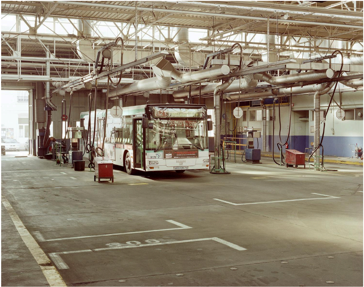
Intérieur du "hall de chargement". Postes de charge (carburant).
