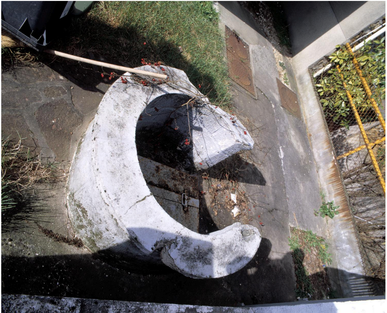
Puits individuel situé sur la parcelle du pavillon situé au 35, rue de la Mutualité.
