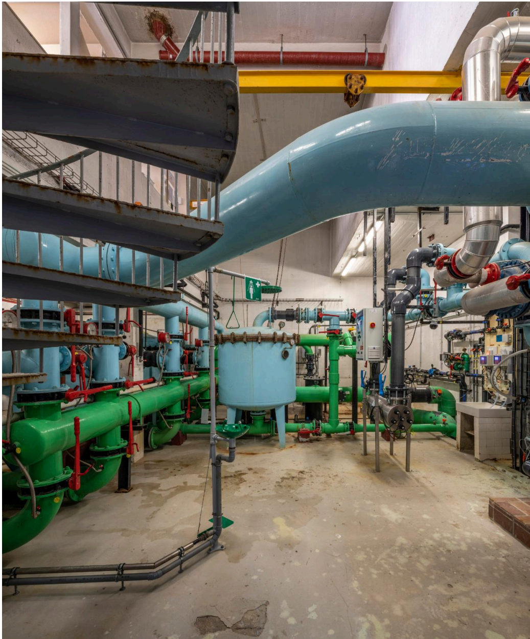
Vue intérieure du local de traitement d'eau, premier sous-sol
