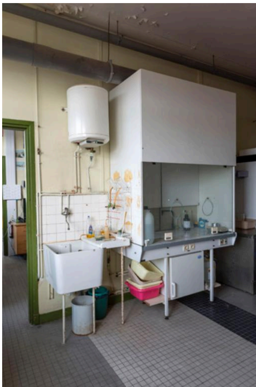
Lycée Rostand : hotte destinée aux manipulations de chimie.
