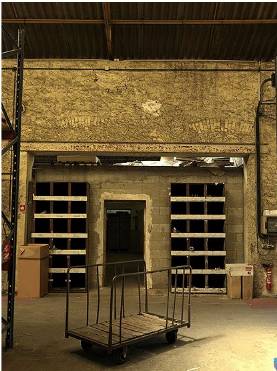
Choisy-le-Roi, entrepôt industriel de l'ancienne faïencerie Boulenger XX, 138 avenue de Villeneuve-Saint-Georges. Vue d'un bâtiment comprenant à l'intérieur des vestiges de cheminée.
