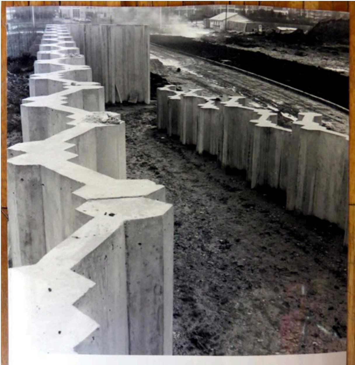
Vue durant le chantier des modules en béton assemblés délimitant les aires d'inhumation et leurs rampes d'accès. Circa 1974. SIAF/CAPA. Fonds Robert Auzelle 242 IFA, boîte 53, affaire RA 17.
