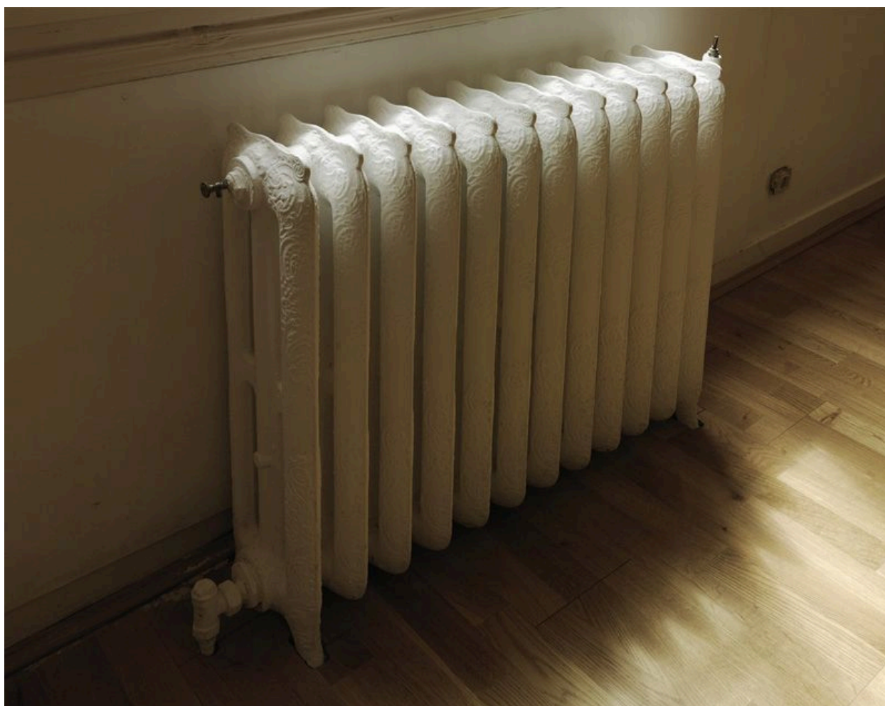
Le radiateur de la salle à manger de l'hôtel du Giboin.
