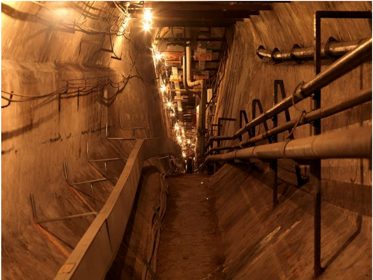
Valenton, usine Alkan, rue du 8 Mai 1945. Autre vue de la circulation souterraine accueillant les réseaux de fluide alimentant les ateliers.
