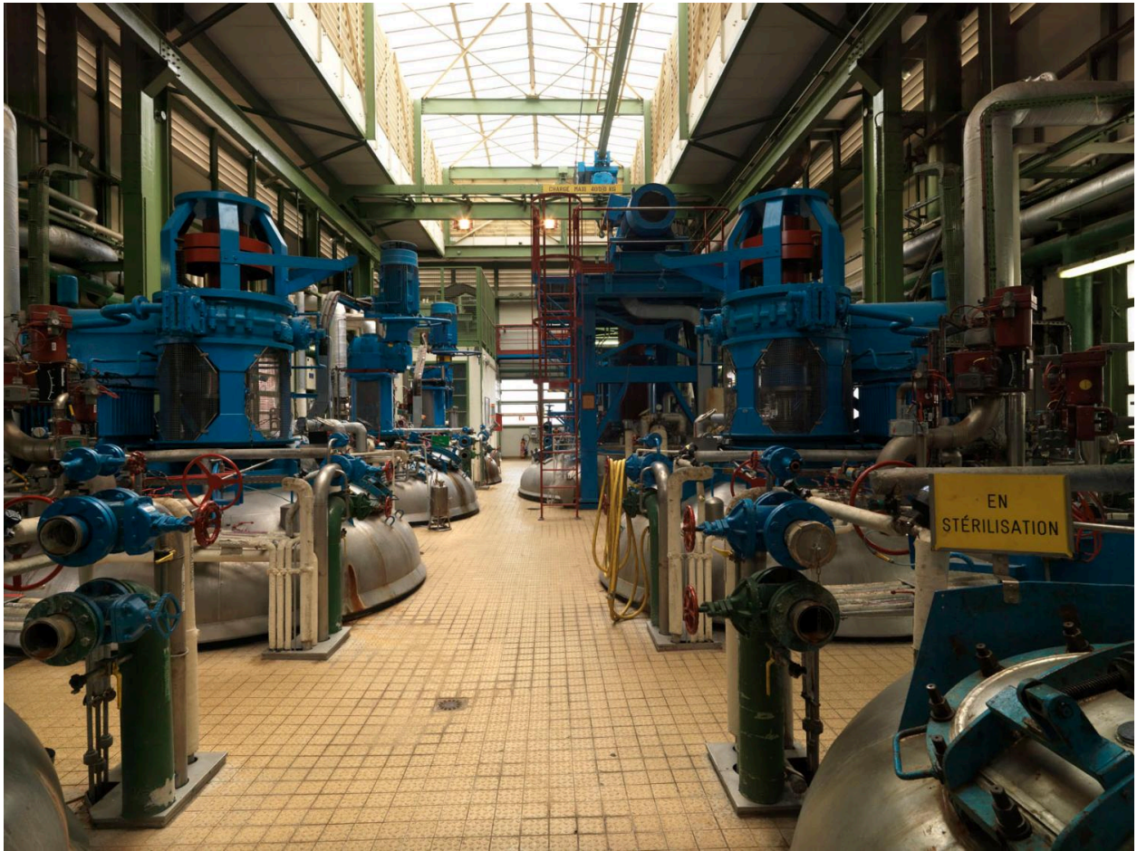
Site Sanofi. Bâtiment de transformation. Cuves.
