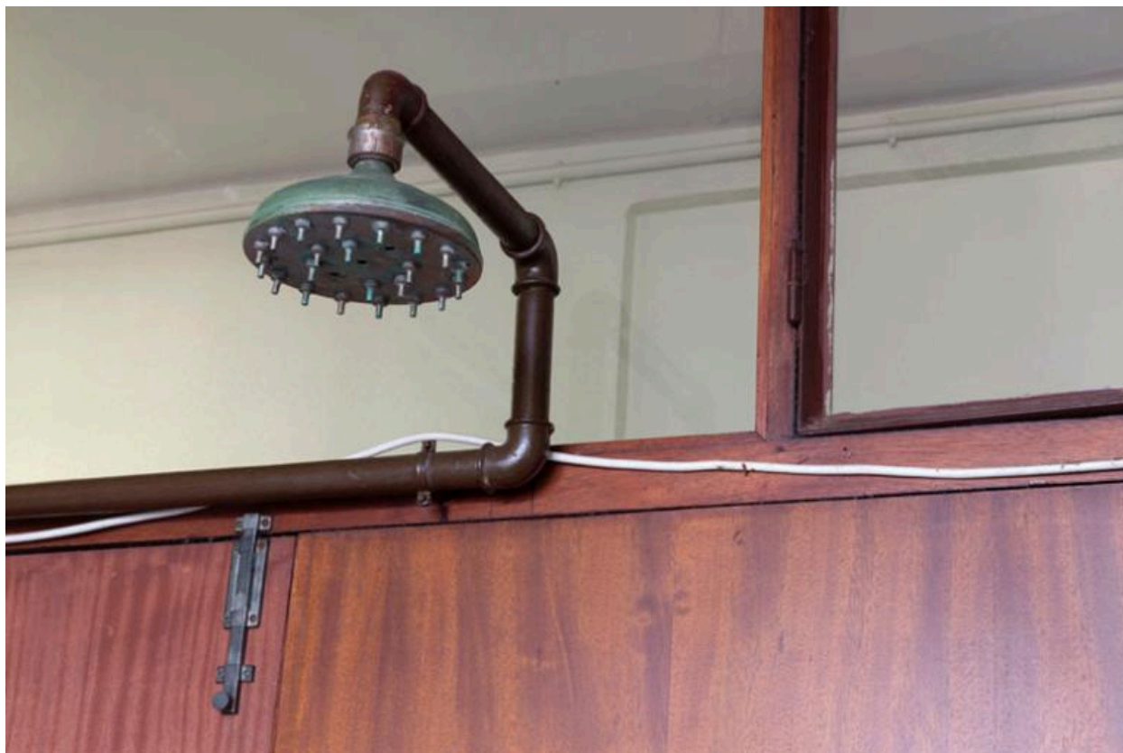
Lycée Rostand : ancienne douche de sécurité dans le laboratoire de sciences.
