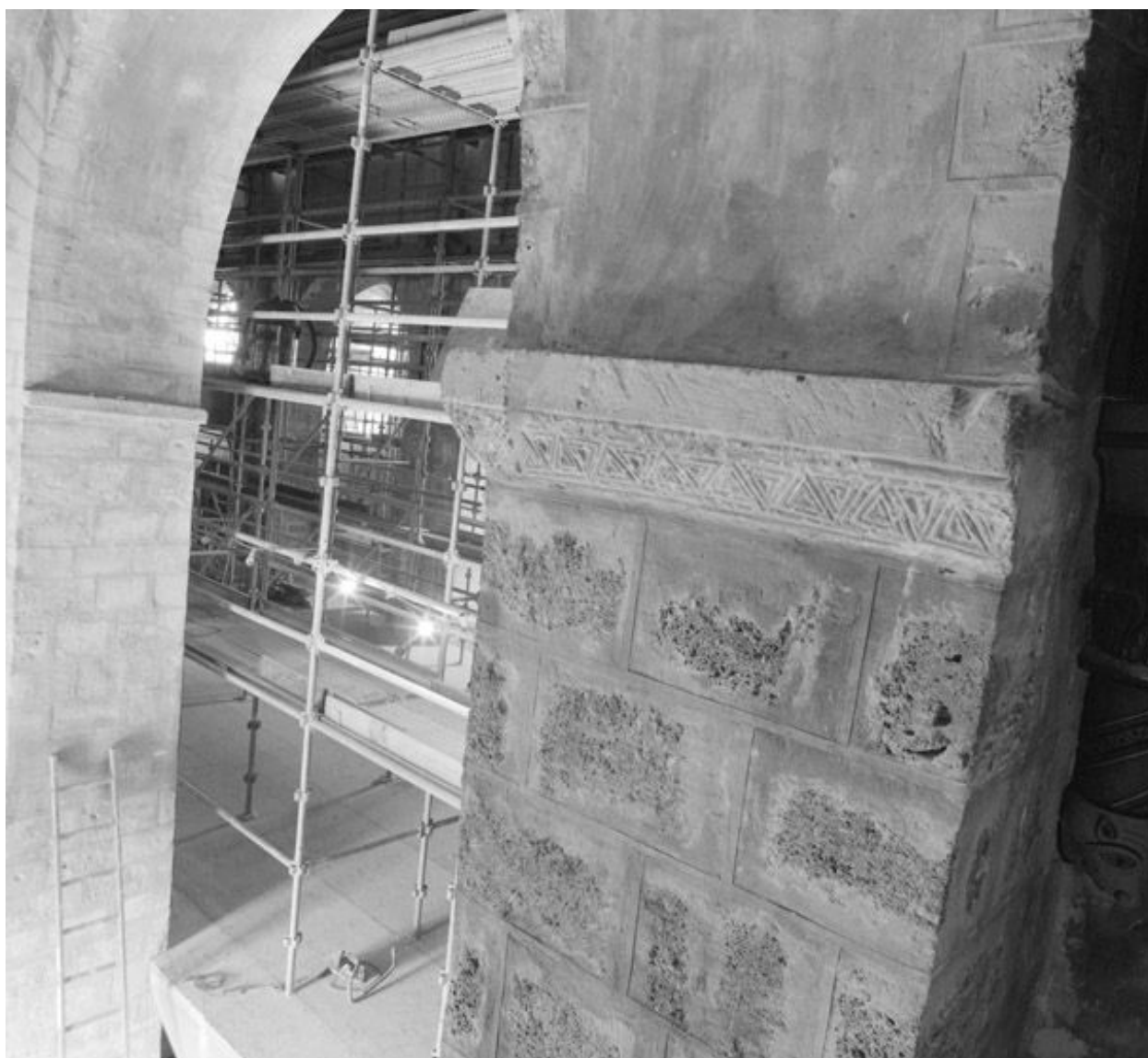
Détail du pilier sud-ouest de la croisée du transept, avec bandeau sculpté à motifs géométriques. Vue prise en 2005, pendant la restauration de la nef.
