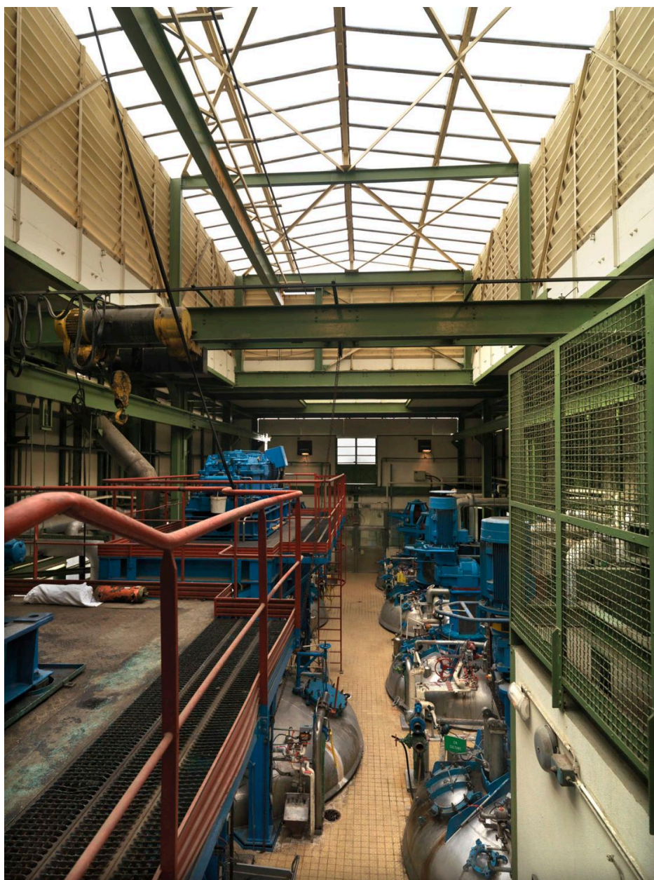
Site Sanofi. Bâtiment de transformation. Cuves.
