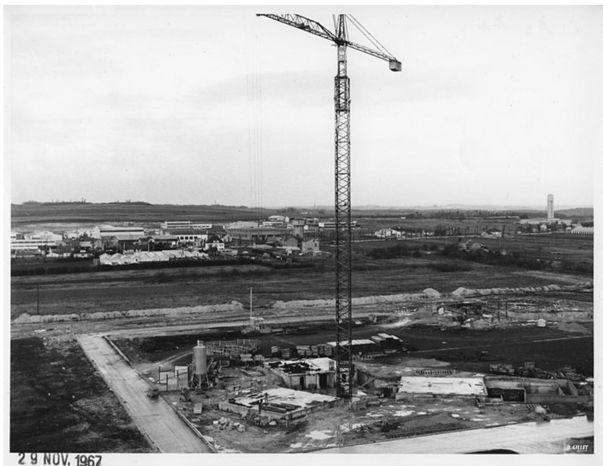
Chantier de construction de Beauval A avec vue sur la ZI. 29 novembre 1967. (OPAC Meaux)
