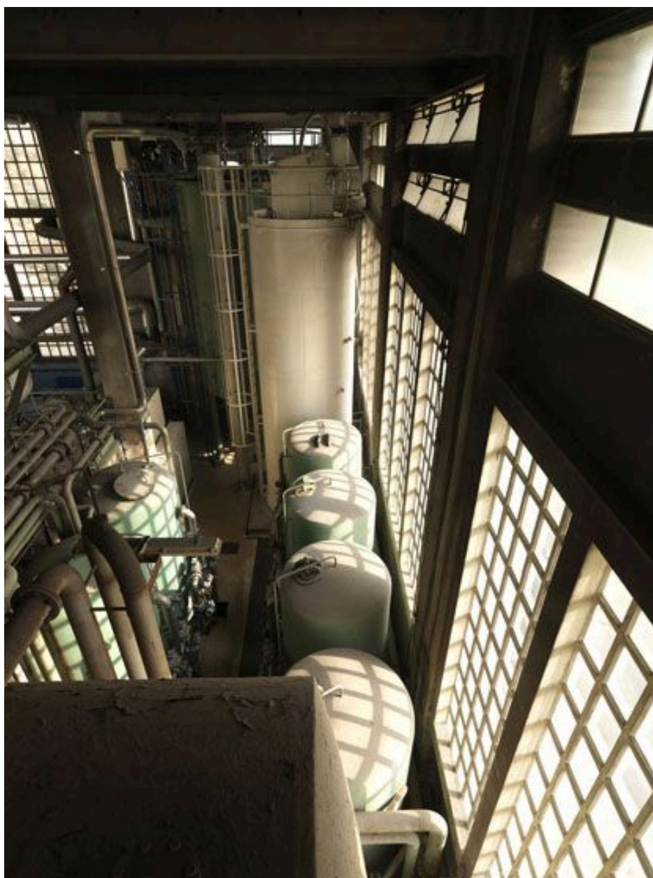
Site Sanofi. Vue des cuves de fermentation.
