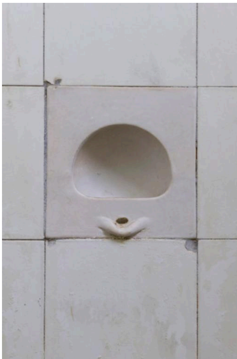
Porte-savon, dans l'une des cabines de bain-douche.
