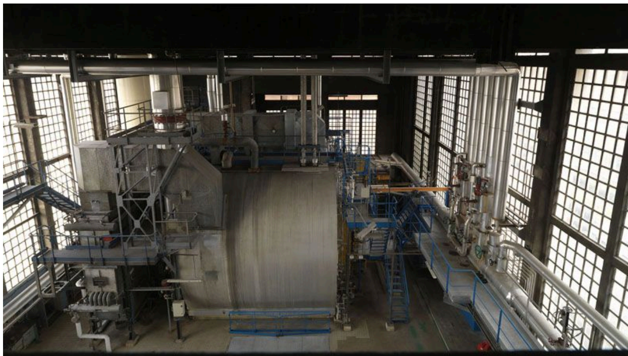
Site Sanofi. Vue intérieure bâtiment de la chaufferie.
