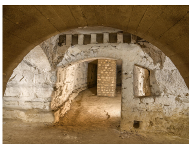
Entrée d'une des caves restée en l'état. La serrurerie composant le système de fermeture est manquant. Phot. Asseline Stéphane IVR11_20249400053NUC4A
