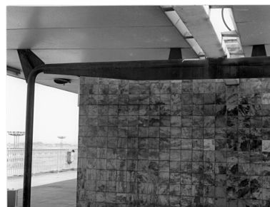
1992, auvent dessiné par Jean Prouvé, la charpente des portiques en tube d'acier porte la toiture en bacs d'aluminium qui repose sur des goussets, décor de carreaux émaillés dessinés par Claude Viseux, 6ème étage. Phot. Jean (architecte) Prouvé, Phot. Claude Viseux IVR11_19929400759X
