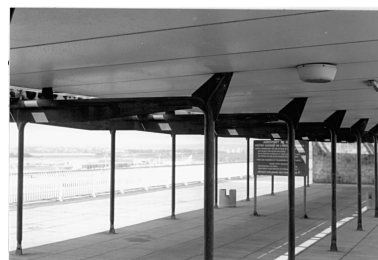
1992, auvent dessiné par Jean Prouvé, la charpente des portiques en tube d'acier porte la toiture en bacs d'aluminium qui repose sur des goussets, 6ème étage Autr. Jean (architecte) Prouvé IVR11_19929400765X
