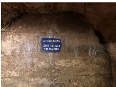
Paris 14e, Jourdan (boulevard) 17. Conduite de chauffage urbain traversant l'aqueduc Médicis sous la Cité Universitaire.
