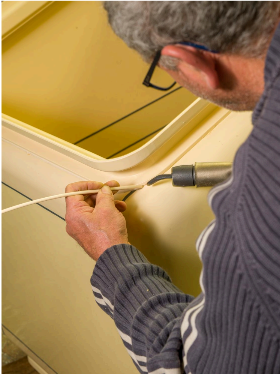
Chaudronnerie plastique. Fabrication d'une enceinte de confinement en PVC. Assemblage des éléments par soudure à air chaud.
